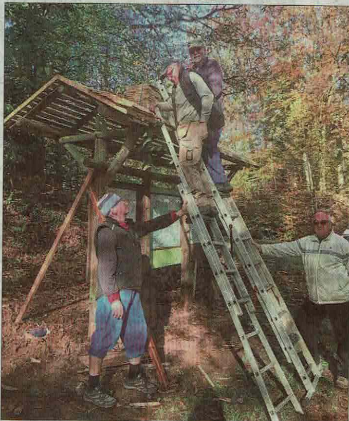
Le portique de signalisation du Club vosgien de Wissembourg a été rénové par de vaillants membres au col du Pigeonnier durant cinq journées. Photo DNA
